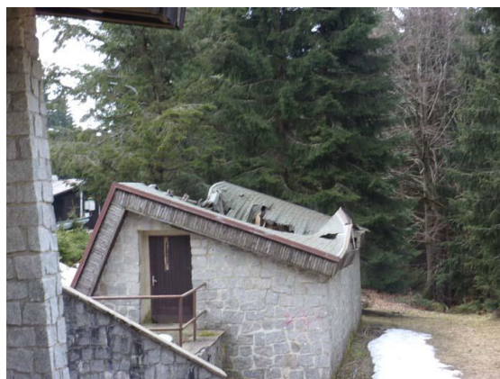
Objekt ČOV (propadlá střecha)
