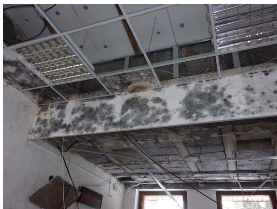
Plísňe na stěnách a podhledech (č. p. 444)
