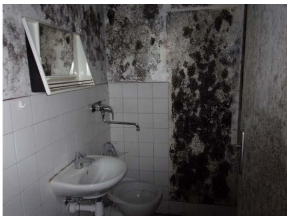
Plísňe na stěnách a podhledech (č. p. 444)
