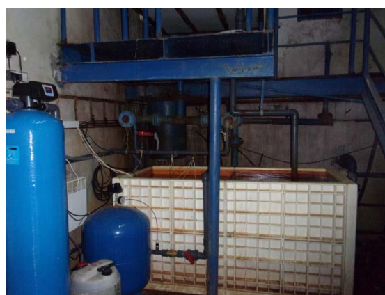
Pohled na část technologie vodárny
